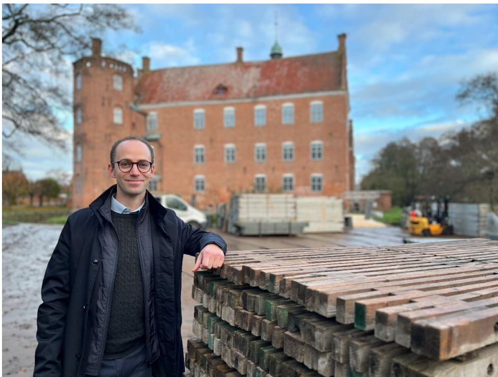
Museumsdirektør Kasper Steinfeldt Tipsmark på byggepladsen. I løbet af november påbegynder Gammel Estrup Danmarks Herregårdsmuseum sit hidtil største restaureringsprojekt, når det 100-år gamle tag på herregården skal udskiftes. Foto: Gammel Estrup Danmarks Herregårdsmuseum.
