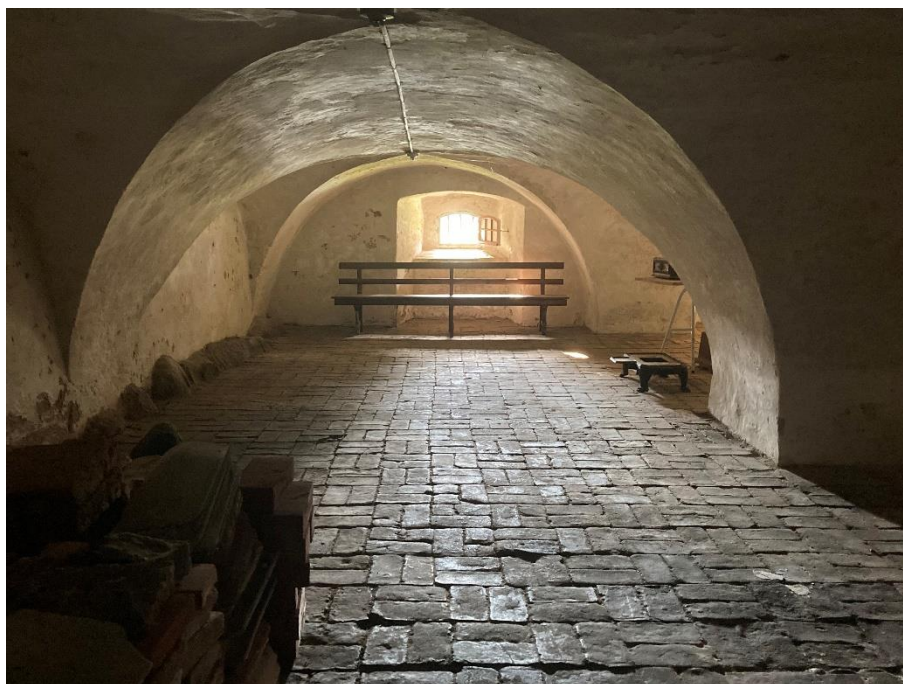
Gammel Estrups kælder ligger faretruende tæt på grundvandsspejlet, og fugtproblemer truer nu både kælderen og hovedbygningens tykke mure. Foto: Gammel Estrup Danmarks Herregårdsmuseum.
